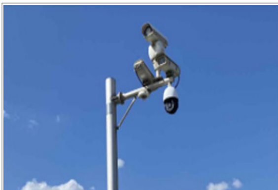
교량에 설치된 CCTV
