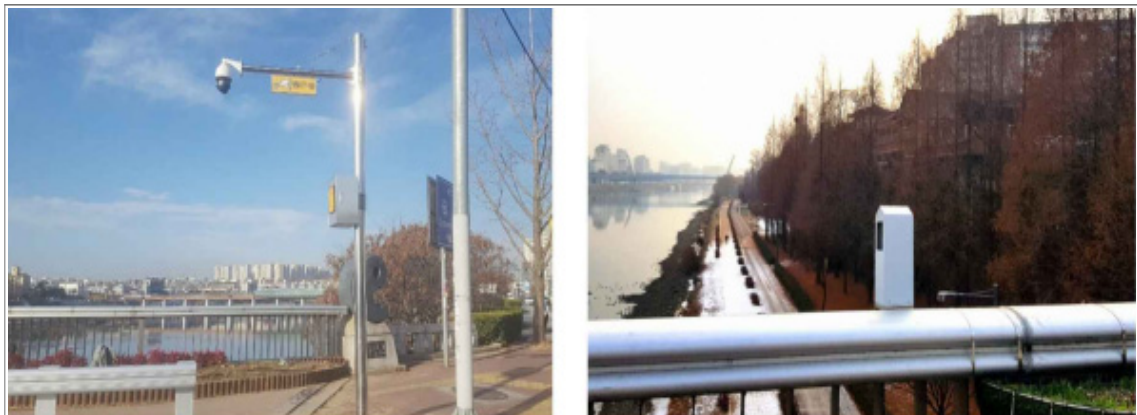
교량에 설치된 스피커
